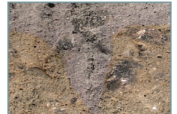
Chloridindtrængningen er forøget omkring det kolde støbeskel - ses som en "tunge" ind fra toppen ca. midt i betonprøven.
