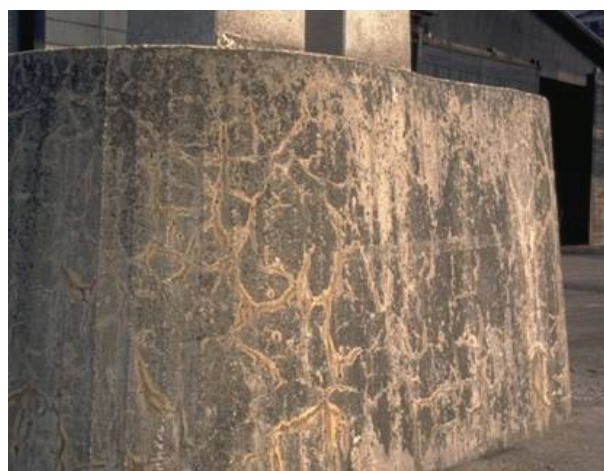
Betonfundament med netrevner som følge af alkaliselreaktioner.
