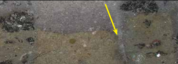
Dybere indtrængning af chlorid - indikeret af det lyse område - i grænsefladen (under afstandsklodsen) mellem beton og afstandsklods end i omgivende beton
