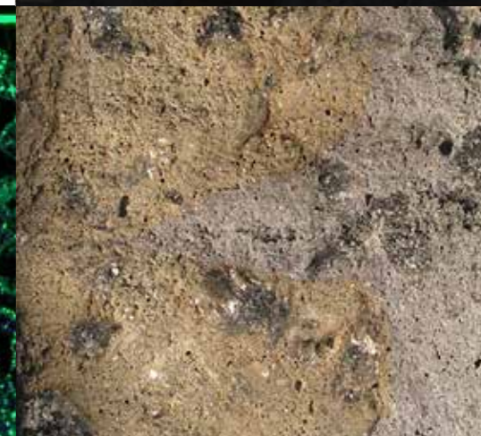
Chloridindtrængningen - indikeret af det lyse område - er forøget omkring det kolde støbeskel. Ses som en "tunge" ind fra toppen ca. midt i betonprøven
